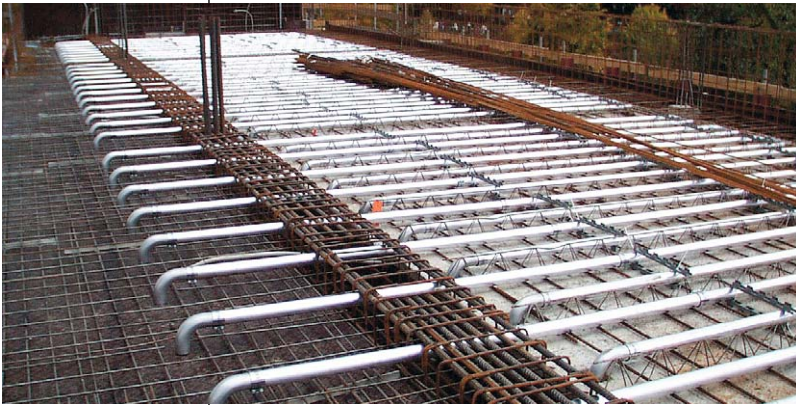
Die innenberippten Lüftungsrohre werden im Gebäuderaster verlegt; damit ist eine beliebige Raumaufteilung möglich.
